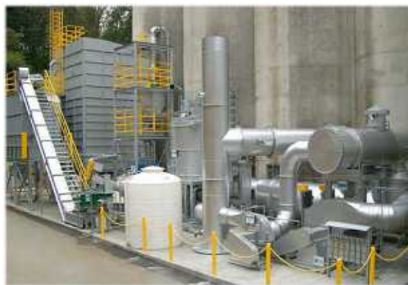
籾殻炭化廃熱利用設備
